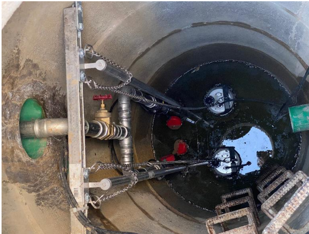
Bild 3: Eine Doppelanlage MultiDrain UV 625 Schmutzwasserpumpen am Gleitrohrsystem im Beton-Außenschacht
