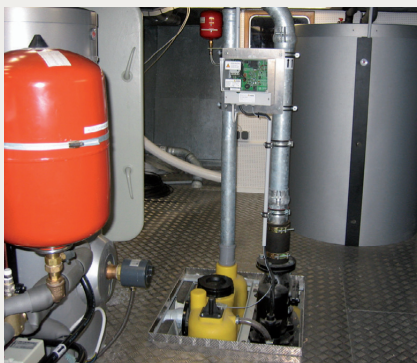
Im Technikraum der „Living on Water“ sorgt eine compli 400 für den sicheren Abtransport des Abwassers
