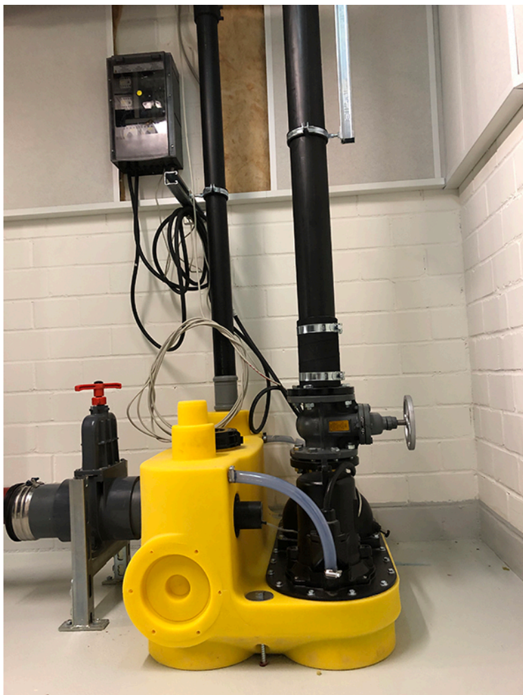
Bild 3: Fäkalien-Hebeanlage compli 1000 pumpt Abwasser bis 17 m hoch
