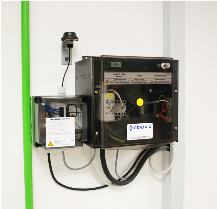
Bild 3: BasicLogo und ältere HighLogo-Steuerungen sowie Jung Pumpen-Produkte mit potentialfreiem Ausgang können mit dem GSM Pro 2-Modem remotefähig nachgerüstet werden.
