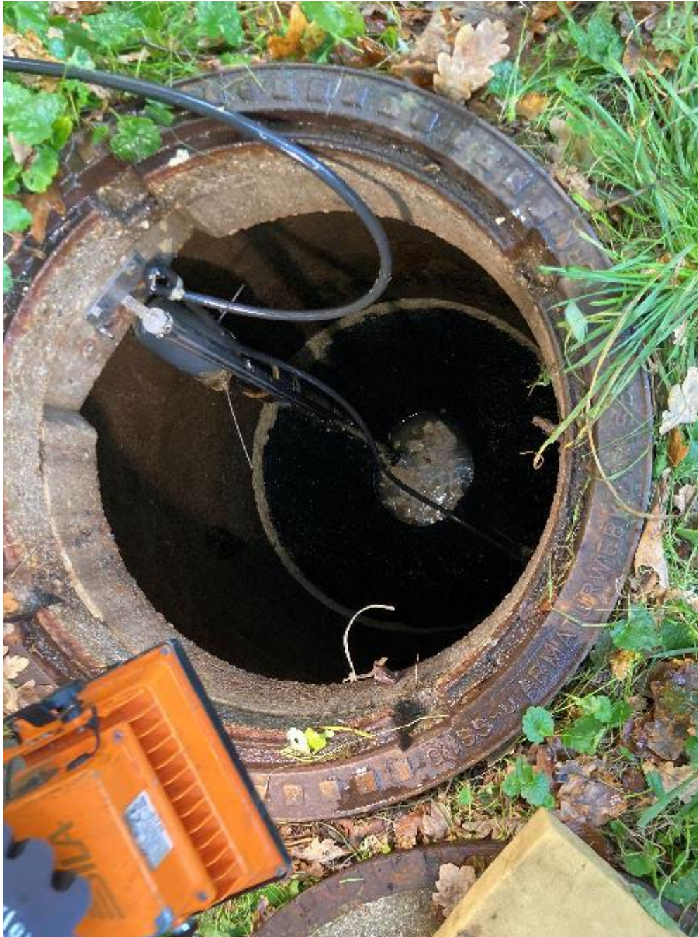
Bild 3: Ursprüngliche Pumpeninstallation mit einer MultiCut Pumpe für die Entsorgung der kompletten Feriensiedlung
