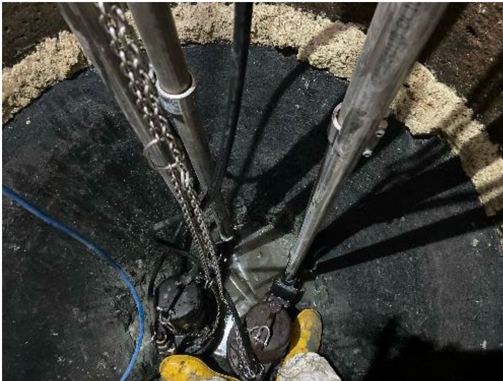
Bild 5: Knapp, aber es passt. Die Pumpen werden abwechselnd in Betrieb genommen und sollte eine Pumpe defekt sein, übernimmt die andere den Notfallbetrieb.
